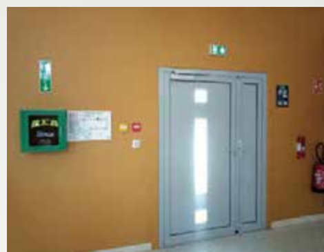
Installation de défibrillateurs dans les bâtiments communaux classés catégorie 2 et 3 recevant du public
